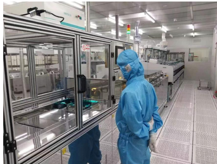
ガラス洗浄 ライン
