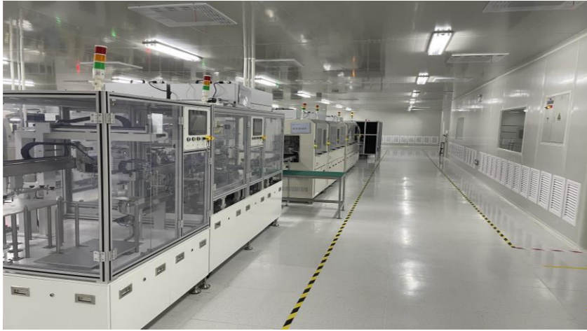
全自動実装ライン クリーンルーム： クラス1000
